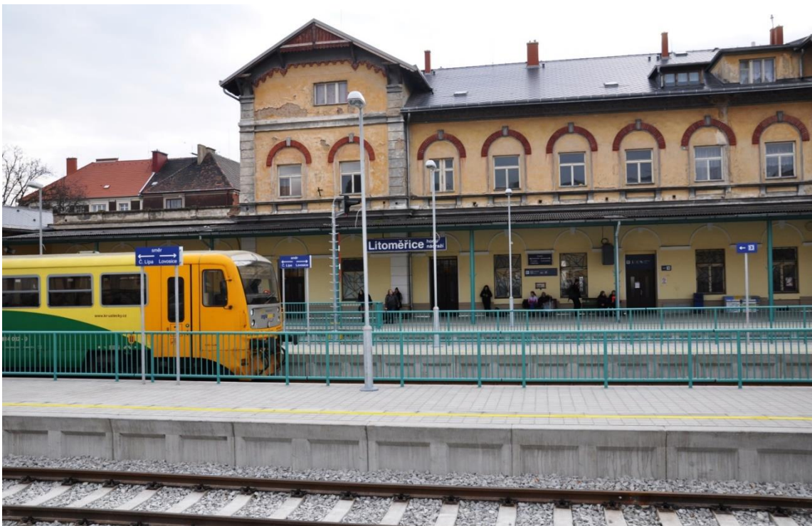
Foto 9 a 10, Rekonstrukce Horního nádraží (kolejiště, nástupiště, úprava dopravního řešení navazujících ulic), snímky z průběhu a po dokončení 12/16.
